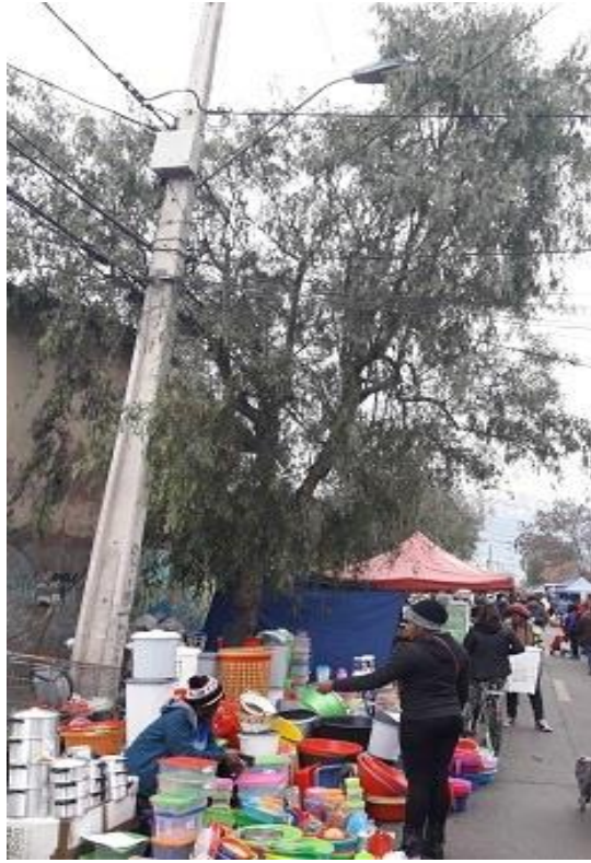
Poda despeje luminaria y cableado aéreo
